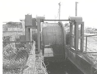
板倉除塵機 (登米市石越町)
